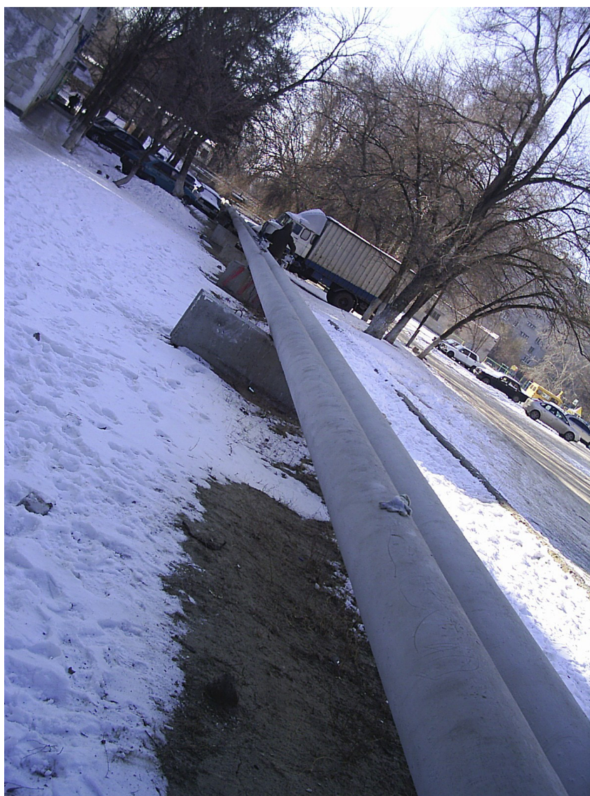
Рис. 3.1 — Общий вид открытого участка теплотрассы
